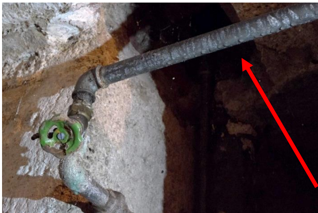
Abb.3: Beispiel Schweißwasser an kalter Leitung.
